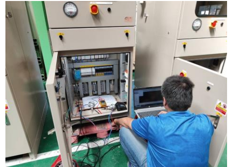
23/24/25 製程區之控制盤盤商自檢
