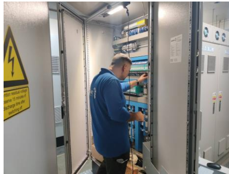
21 製程區之離心機技師自檢盤體
