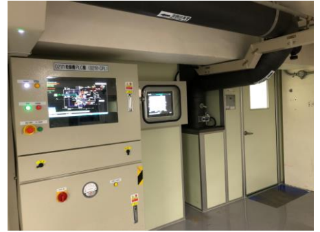
21 製程區之乾燥機程控與潔淨室人機
