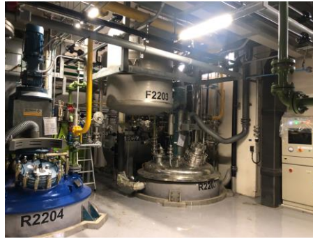
22A 製程區之製程桶槽與控制盤一隅
