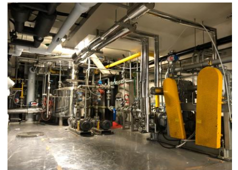
22A 製程區之乾燥機附屬設備一隅
