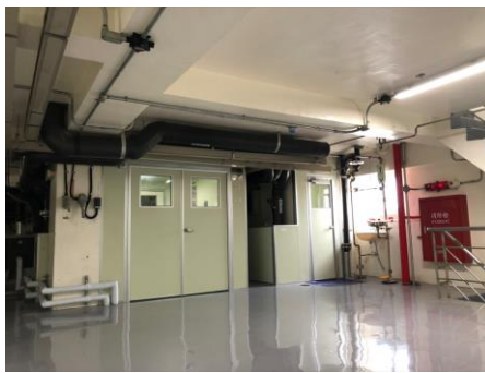
21 製程區之 2 樓潔淨室外景與消防設施
