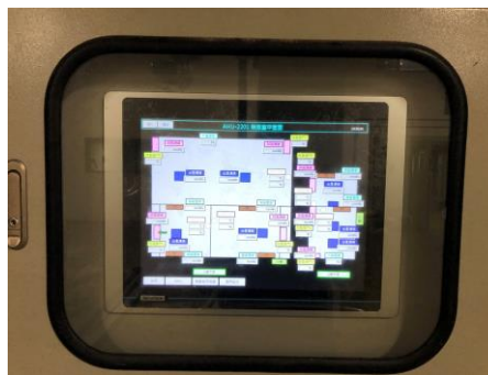
空調系統之人機監測圖控測試
