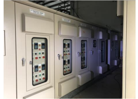
B 廠區公設之冰凍水系統電盤
