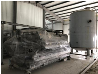
B 廠區施建公設之凍水系統一隅
