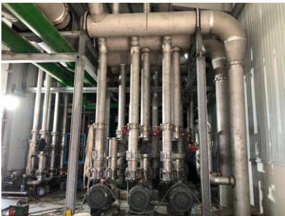
B 廠區施建公設之冰水系統一隅
