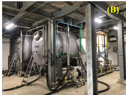
(B) 新建 2 座蒸餾塔一景
