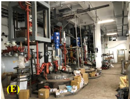
(A) A 廠之 15/16 區外觀 (B) B 廠區外觀 (C) 16 區 3 樓 (D) 16 區蒸餾系統一隅 (E) 15 區配管一隅
